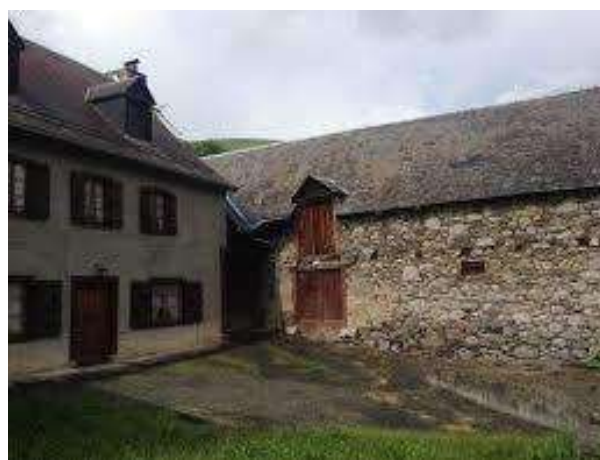
Toiture sans gouttière
